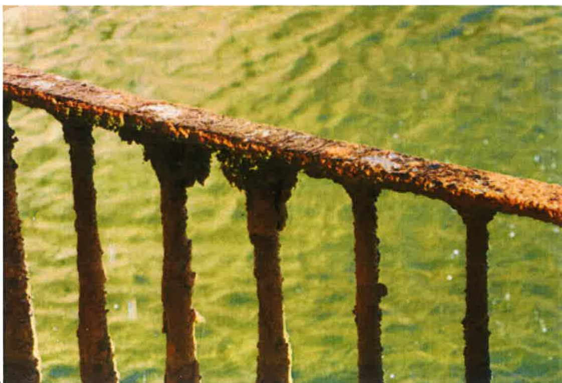
Figura 4. Detalle de los deterioros de la barandilla por su permanente exposición al salpiqueo del agua.
