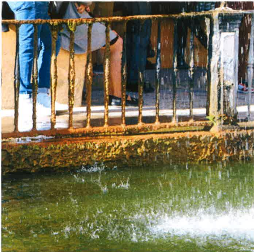
Figura 3. Barandilla de estanque de Mercurio. Las intervenciones que se propongan deben incorporar la conservación preventiva como base de sus actuaciones. El llamado "chorrón", instalado a finales del siglo pasado, ha generado importantes deterioros debido a las salpicaduras.
